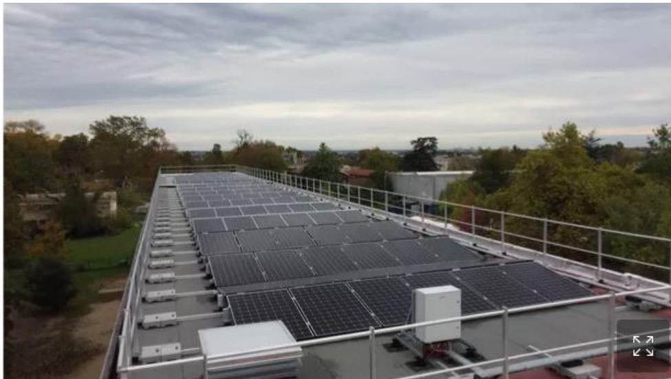
Les nouveaux panneaux solaires installés sur l'école du Burck. Ville de Mérignac
