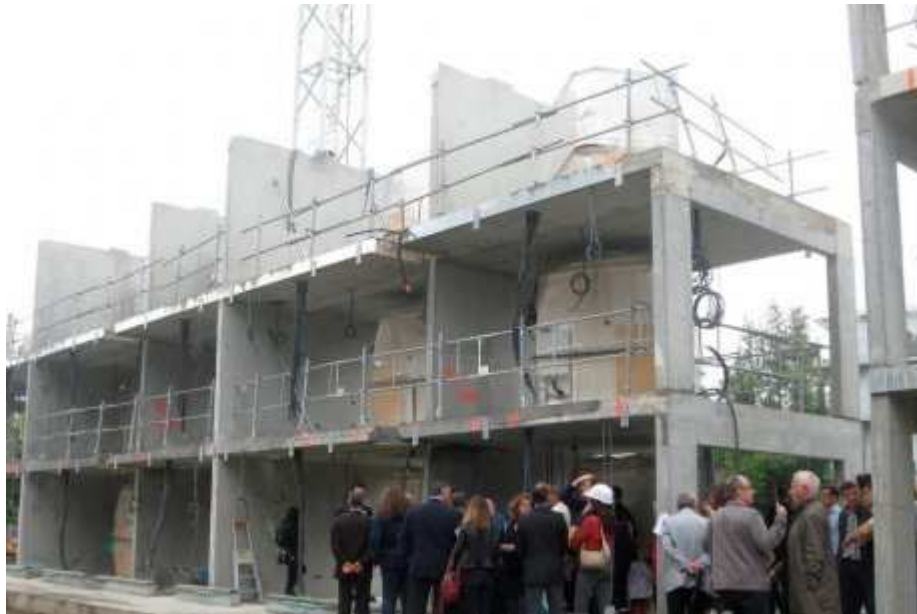
Des salles de bains préfabriquées sont montées à la grue dans les studios avant leur fermeture. (Photo O. D.)
