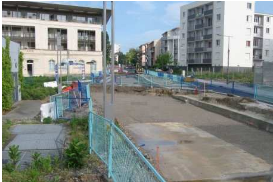
Une émergence du parking a été découverte dans le prolongement des grilles d'aération de l'enceinte souterraine. (Photo O. D.)
